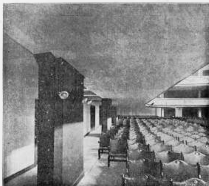
Balcon in gewapend Beton in Geb. v. Kunsten en Wetensch. te 's Gravenhage.
