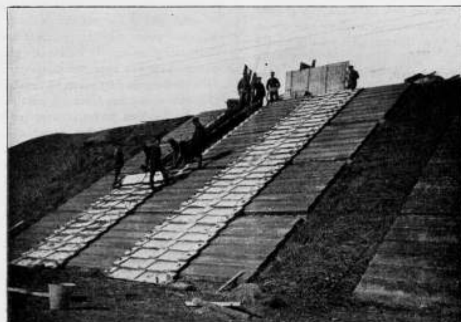
Fig. 19. Het maken van platen op een talud steiler dan een op een. (Gedeeltelijke kanaaloever in harde kci.)
