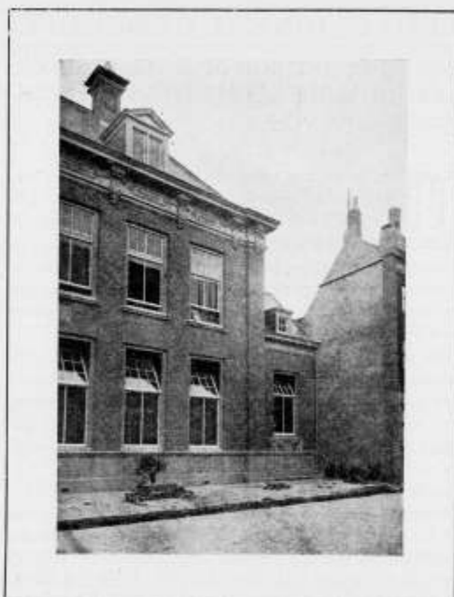
Afb. 4. Nieuw Postkantoor te Middelburg. Het springt terug uit de rooilijn; de raamverdeling is niet in overeenstemming met den stijl van het gebouw; de muren der belendende perceelen zijn gepleisterd; het rechte gebouw en trottoir vloekt met de schoone gebogen lijnen der Noordstraat.
