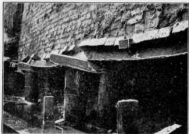
Fig. 2 en 3. Bouwvallige fundeering van perceel Dapperstraat n° 127.
