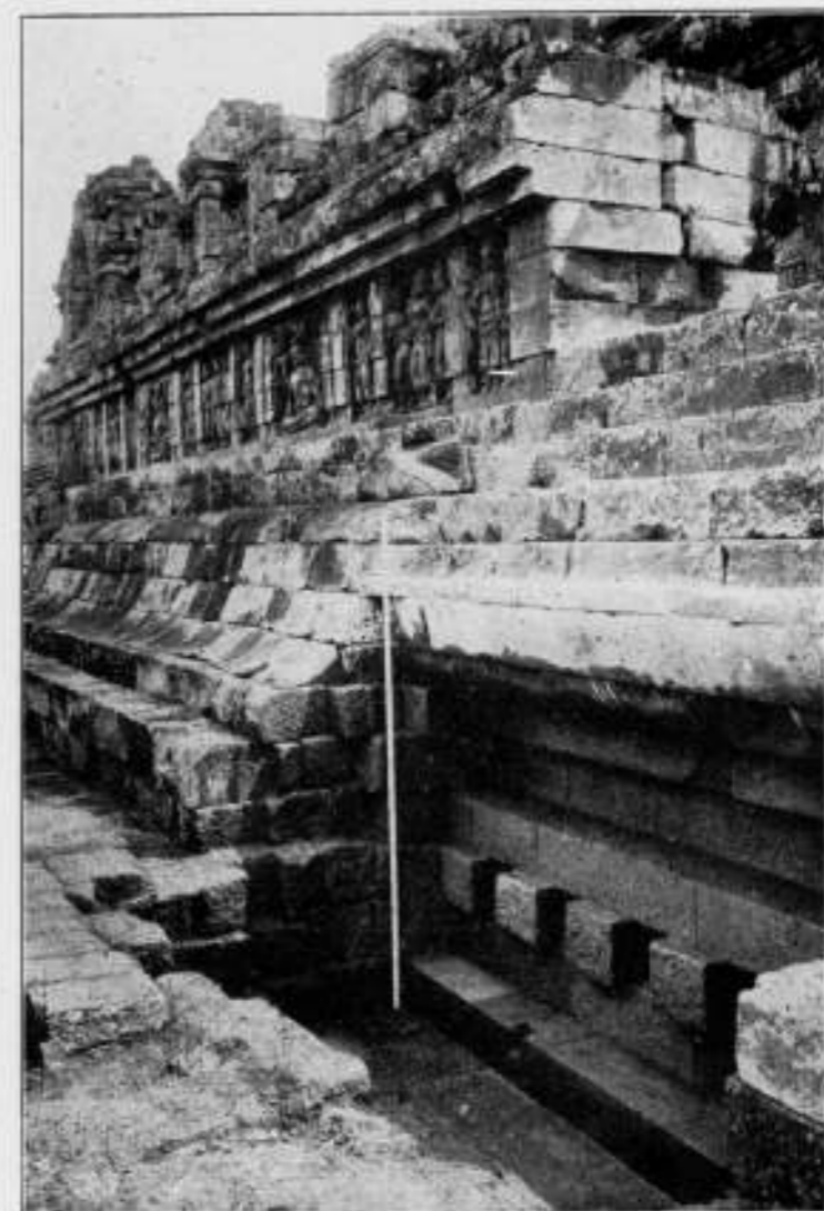
Fig. 6. Breekgat ter plaatse van den Zuidelijken opgang met blootgelegd gedeelte der profilering van den oorspronkelijken voet.
