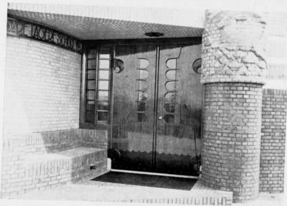
HOOFDINGANG O.L. SCHOOL TE GOUDA. ONTWERP H. v. d. MEER, HOOFDOPZICHTER VAN DEN DIENST VAN OPENBARE WERKEN.
