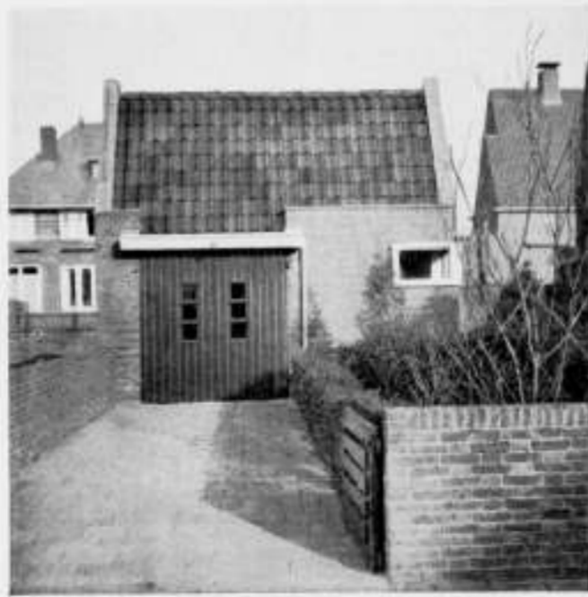
WAAROM ZAKT HET DAK DOOR?
