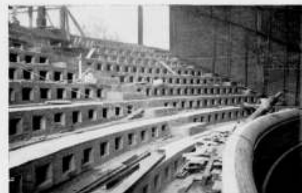
OPENINGEN VAN DE AFVOERROOSTERS BALCON SCHOUWBURGZAAL. DEZE 3 FOTO'S AFGESTAAN DOOR DEN HEER J. DE RIDDER!
